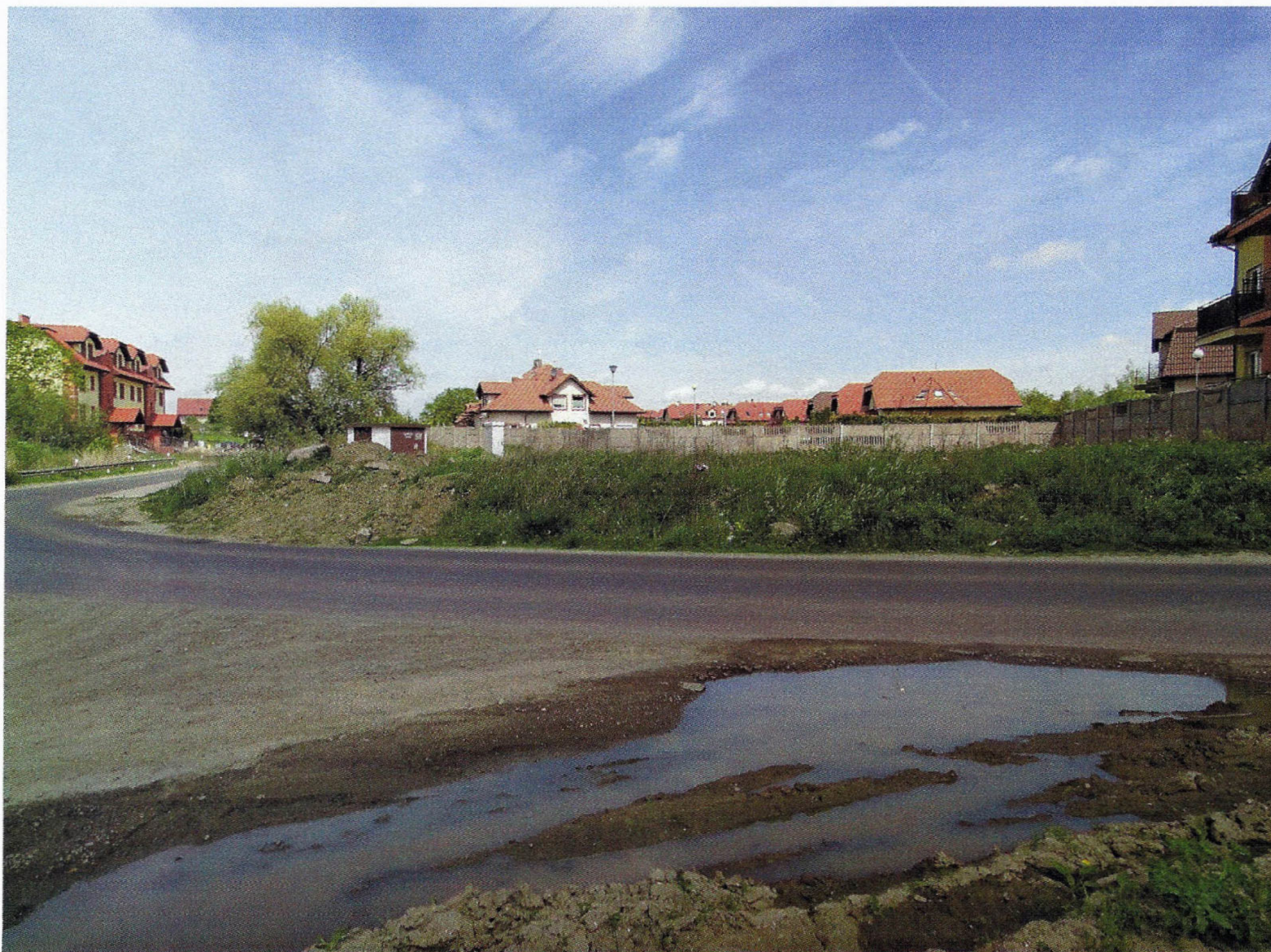
Fotografia 4 Zakręt ulicy Wapiennej i druga "dziura" w ciągu pieszym.
